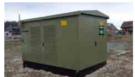
Die neue Trafostation
